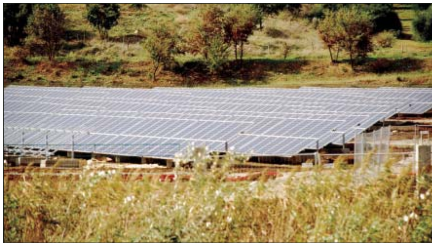
Un parco fotovoltaico
