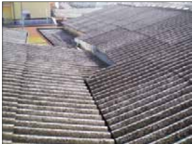
Coperture in amianto di abitazioni private
