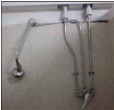
Una delle docce divelte negli spogliatoi degli ospiti
