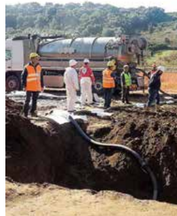
BUCO NELL'OLEODOTTO I tecnici sul luogo della perdita
