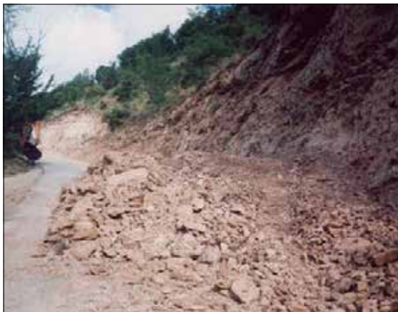
Una strada coperta da una frana
