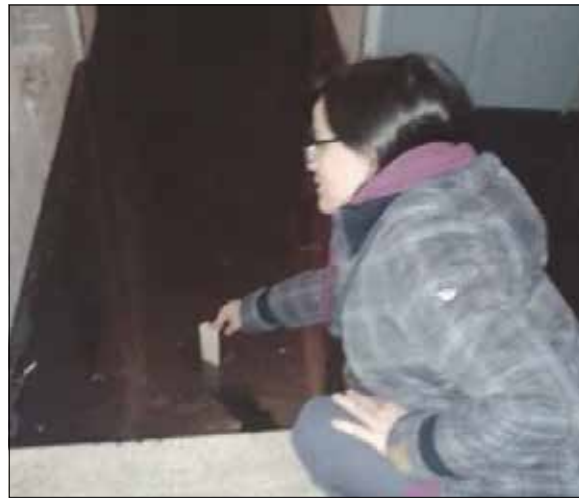
Una residente mostra il laghetto di liquame nelle cantine della palazzina Ater
