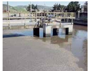
RIFIUTI L'impianto di trattamento di Tecnoparco
