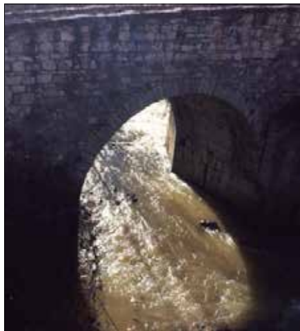
Il Ponte di San Vito e, in acqua, alcuni pezzi caduti
