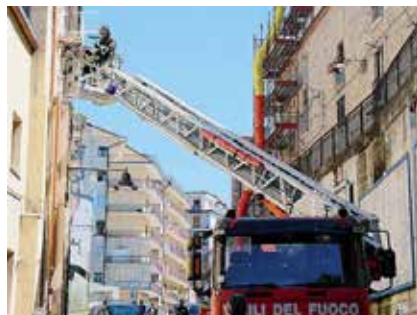
VIA IV NOVEMBRE Vigili del fuoco impegnati a rimuovere calcinacci
