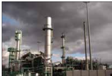
Il Centro Oli di Viggiano
