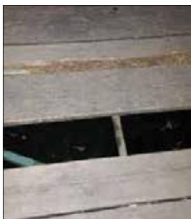
Il particolare dell'asse mancante sul ponticello di legno in Villa a Melfi
