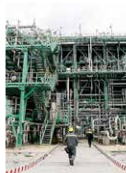
IMPIANTO Centro olio di Viggiano
