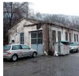
DEGRADO Il prefabbricato [foto Tony Vecce]
