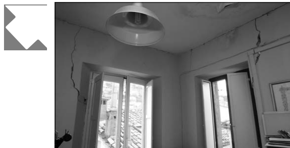
Una delle strutture di Mormanno danneggiate dal sisma di magnitudo 5 del 25 ottobre 2012
