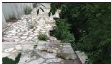
La frana che interessa la scalinata che porta all'abbazia
