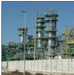
Il Centro Oli di Viggiano
