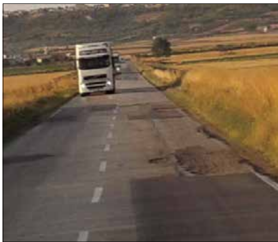
Le condizioni precarie della strada
