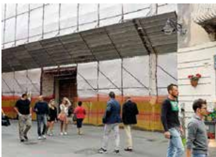
POTENZA La chiesa della Trinità transennata
