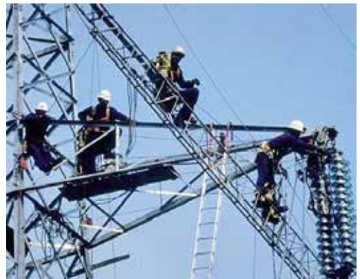
LINEE AEREE Un intervento su un traliccio dell'alta tensione
