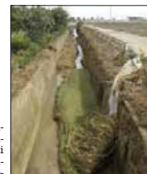
Un canale del Consorzio di bonifica vistosamente intasato
