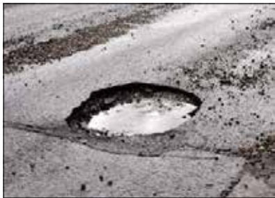
Una buca nei pressi del passaggio a livello tra Rionero e Barile
