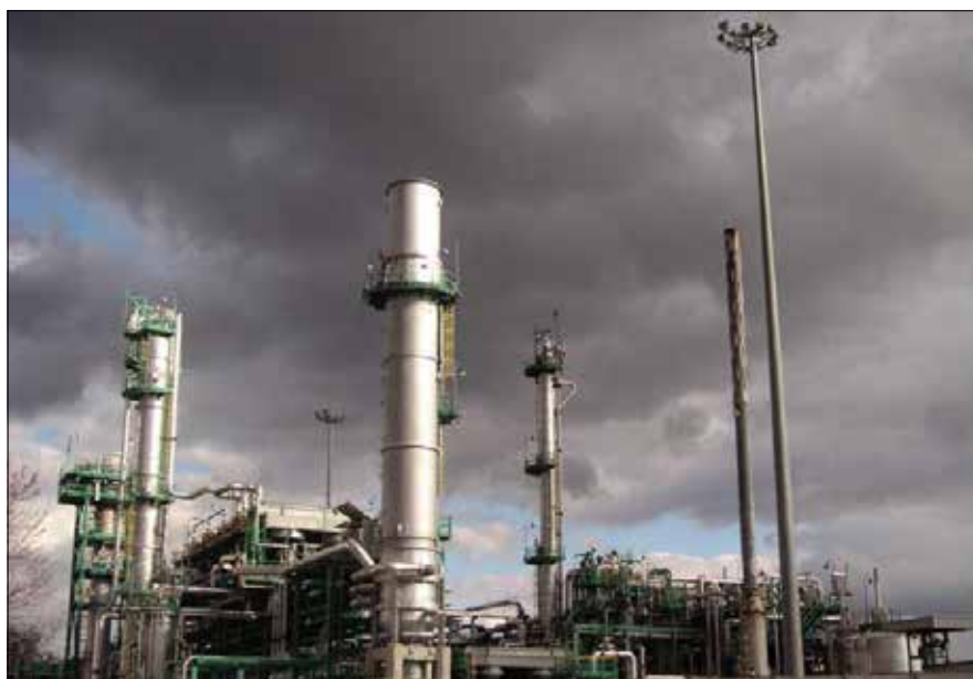
Il Centro oli dell'Eni di Viggiano è l'infrastruttura fondamentale del programma di estrazioni di petrolio e gas in Val d'Agri
