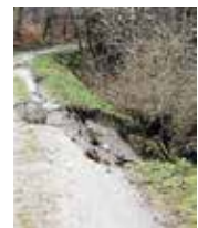
NEMOLI La frana
