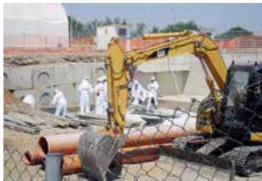
NUCLEARE ITALIANO Lo scorso anno la fuoriuscita di liquido dal monolite in cemento armato contenente rifiuti radioattivi
