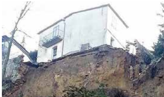
FRANA Uno dei punti in cui si vede in modo evidente la frana di Montemurro
