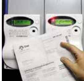
SERVIZI Contatori di energia elettrica
