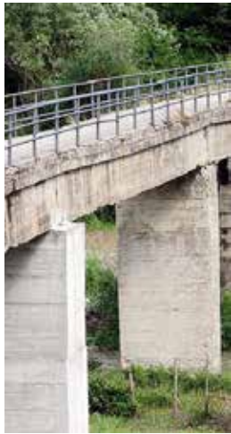
CHIUSO AL TRANSITO Il ponticello che di fatto da febbraio 2014 isola la famiglia Spadola
