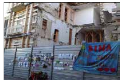
La palazzina crollata l'11 gennaio 2014 in vico Piave nel centro storico della città
