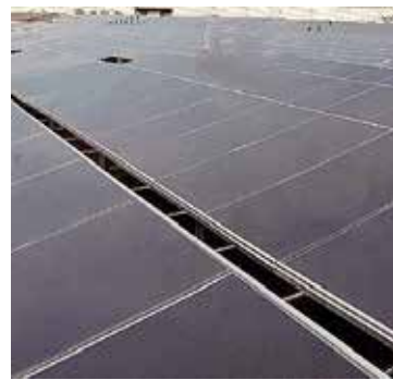
IMPIANTO Alcuni pannelli solari
