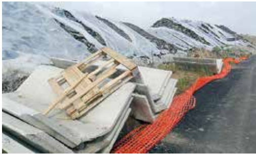
LAVORI E SCEMPI I cumuli di rifiuti inerti derivanti dagli interventi di raddoppio lungo la statale 106 Jonica [foto Mele]
