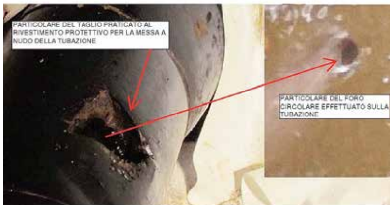
FORO Il danneggiamento dell'oleodotto Eni a Bernalda
