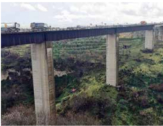
IL VIADOTTO SULLA 658 Il luogo dell'incidente sulla Potenza-Melfi [foto T. Vece]
