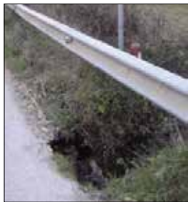
La buca sulla strada
