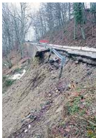
FRANE E SMOTTAMENTI Un tratto della ex 277
