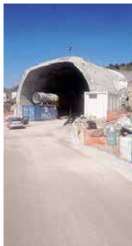
IL CANTIERE La galleria sull'A3 dove perse la vita l'operaio Giuseppe Palagano
