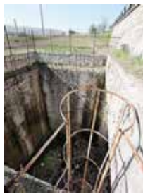
VASCONC Degradato e abbandonato
