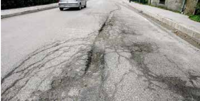
MANUTENZIONE STRADALE Asfalto danneggiato dopo la stagione invernale
