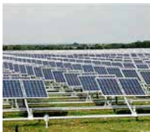
SALENTO Impianto di fotovoltaico
