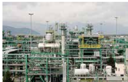
CENTRO OLI La Tucam è un'azienda dell'indotto del Centro oli di Viggiano
