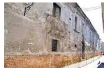
RISCHIO CROLLO Palazzo Caputo a Spinosa
