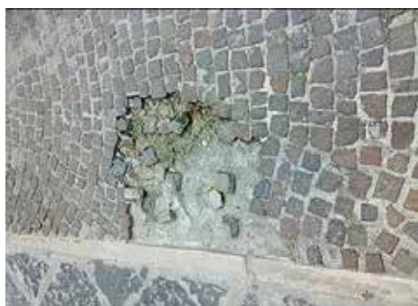
DEGRADO Buche nel centro storico
