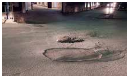
DEGRADO Tombini e avvallamenti a Portaslazza
