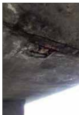
Lo stato di degrado del ponte Musmeci
