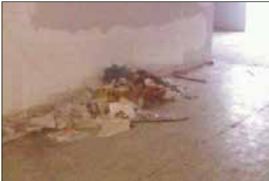
Sporcizia e detriti all'interno della struttura scolastica
