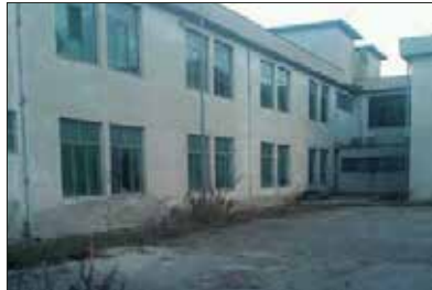
Le finestre con i vetri quasi tutti rotti dai vandali e dal vento
