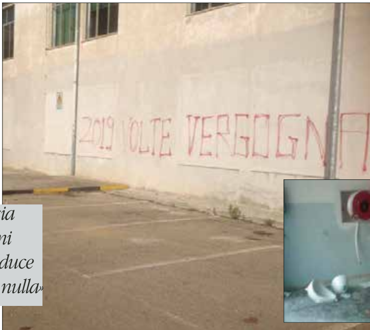
La scritta che campeggia all'esterno dell'edificio scolastico in via Bramante e a lato sanitari infranti e strutture antincendio divelte
