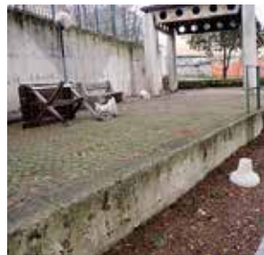
PANCHINE ROVESCIATE Degrado in villa (foto ddi)
