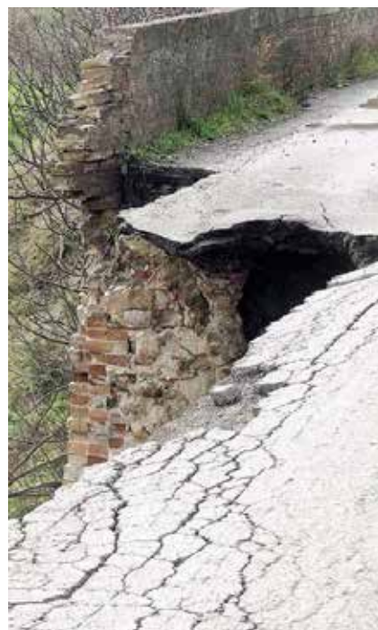
LA STRADA FRANATA L'interruzione sulla Pistici-Craco
