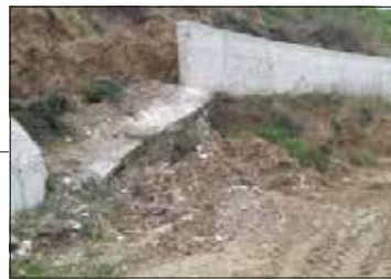
Il muro realizzato nel 2011 e già crollato
