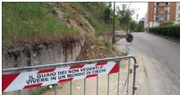
L'interruzione della strada a Poggio Tre Galli
