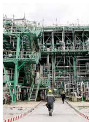
ORIGINE DI TUTTO Il Centro olio della Val d'Agri da cui parte il greggio che arriva a Taranto con l'oleodotto (foto Tony Vecce)
