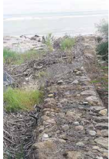
DISTRUTTE Le briglie del canale dell'idrovora [foto Mele]
