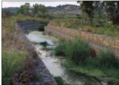
Lo scarico fognario a cielo aperto
