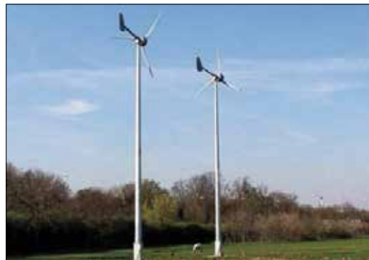
Un impianto di mini-eolico
