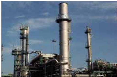
Il Centro Oli di Viggiano
