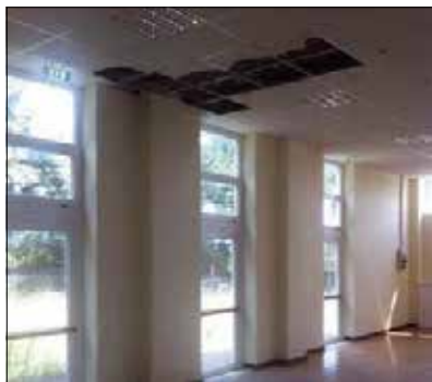
Il cedimento del soffitto
