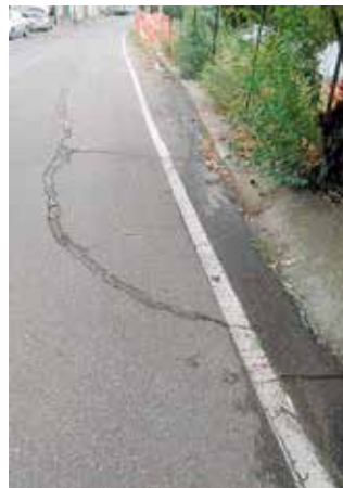
PIANO STRADALE Il tratto oggetto all'avvallamento
