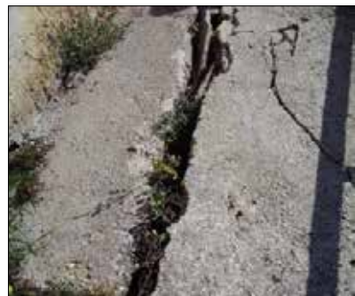
Una delle strade: evidente la frana in corso
