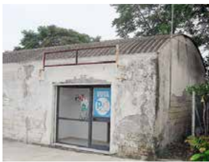
FIBRA KILLER Il tetto in amianto della sede locale del Pd
