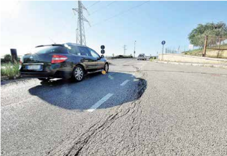
TRANSITO PRECARIO Il tratto sconnesso in curva in contrada Aia del Cavallo [foto Genovesi]
