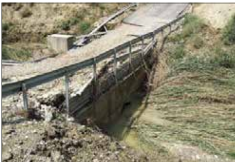
Il tratto provvisorio dopo la tragedia avvenuta mercoledì pomeriggio
