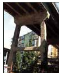
Le pessime condizioni in cui versa il Ponte che collega Montereale
