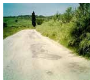
DEGRADO Lo stato della sp 33
